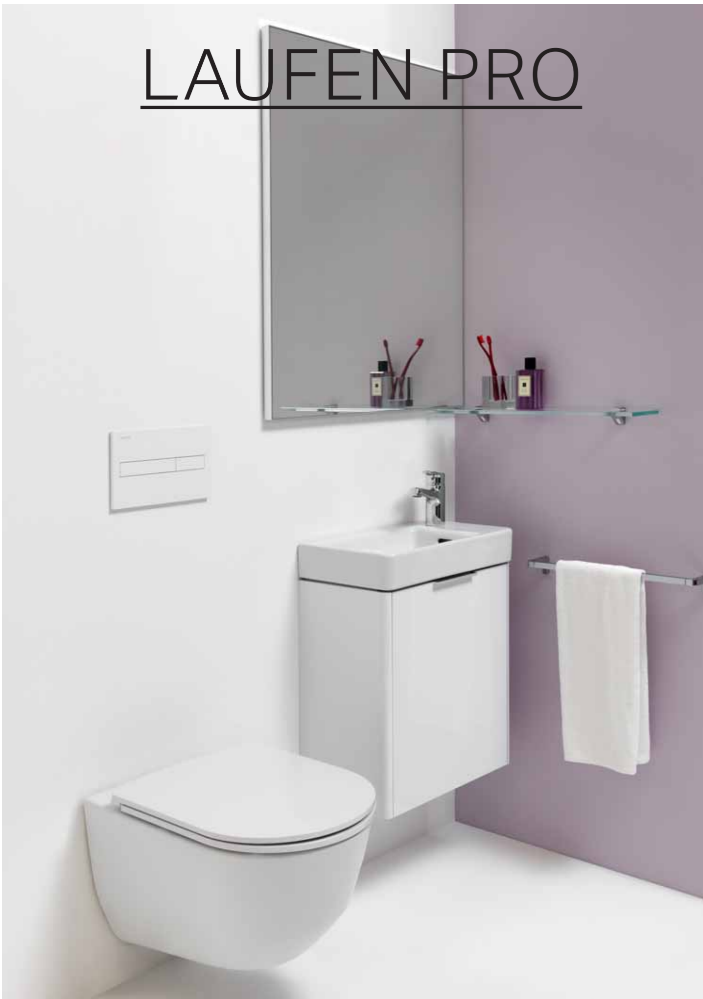
LAUFEN PRO S компактная раковина 48 с полочкой для смесителя справа; LAUFEN PRO подвесной безбодковый унитаз; BASE модуль под раковину; FRAME 25 зеркало, стеклянная полочка CITYPRO смеситель для раковины LIS панель смыва
